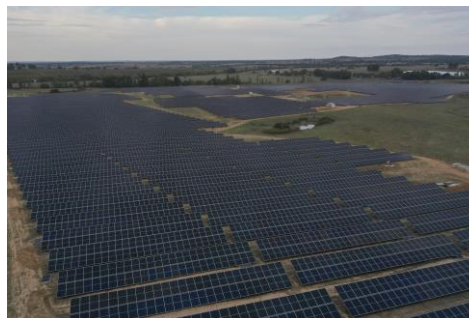
MENDO MARCO – PORTUGAL 23.3MW
